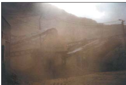
Ausencia total de medidas de control
